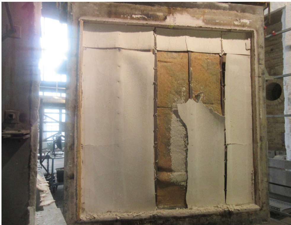
Côté exposé après l'essai.
